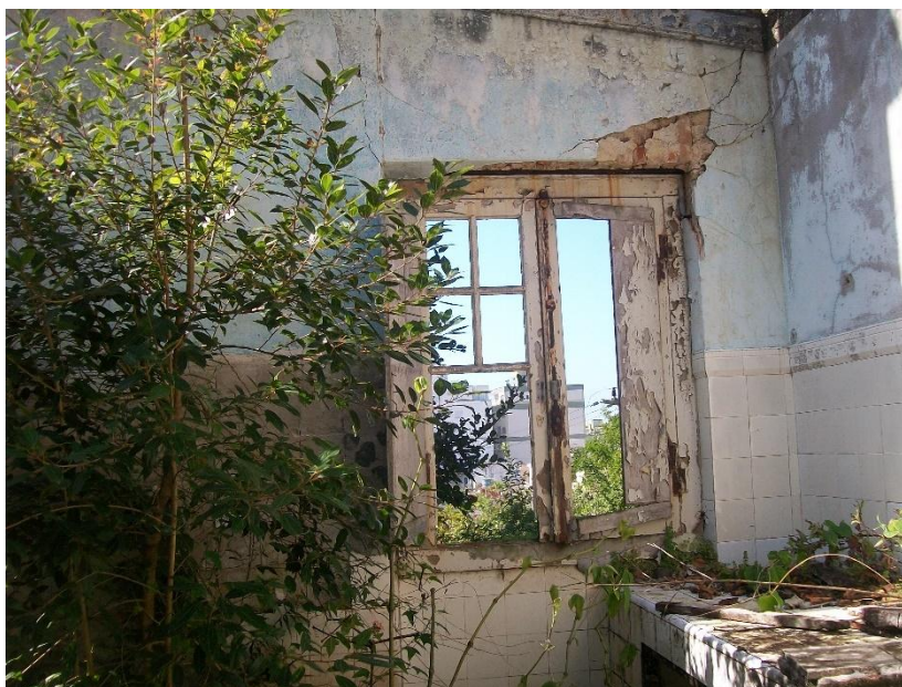
Figura 9: Única esquadria existente
