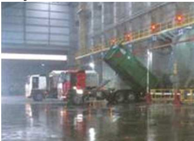
Figura 26: Área fechada de coleta dos resíduos.
