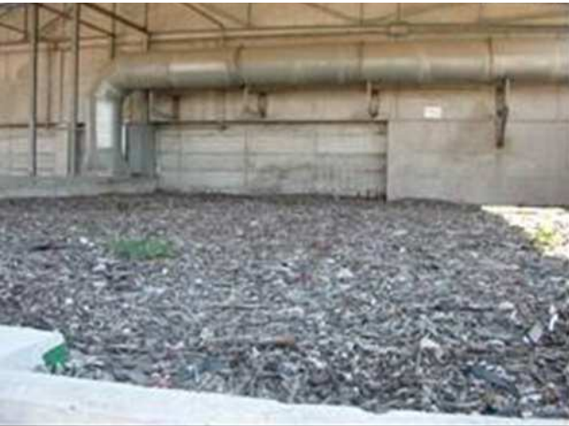
Figura 11: Biofiltro para filtragem do ar que sai de dentro da estação de tratamento.
