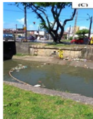
Figura 12 - Ecobarreira em funcionamento (A), remoção dos resíduos (B) e finalização da limpeza (C) no Canal do Vasco da Gama (Arruda) em Recife.
