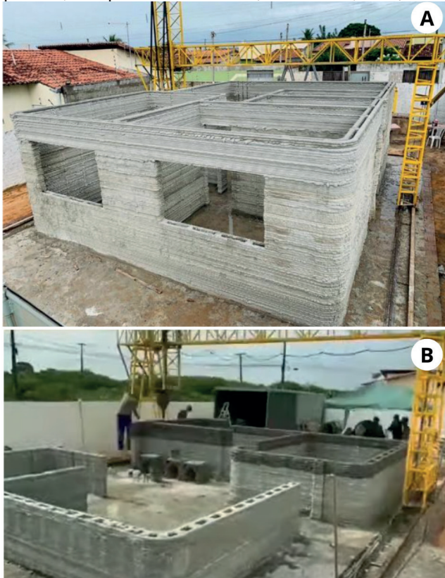
Figura 10: Vista do processo de impressão das paredes da casa (a) e (b). Fonte: MARTINELLI (2020).
