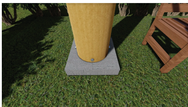
Figura 17 – Detalhe da base de concreto com tubo de papelão fixado Fonte: As autoras.
