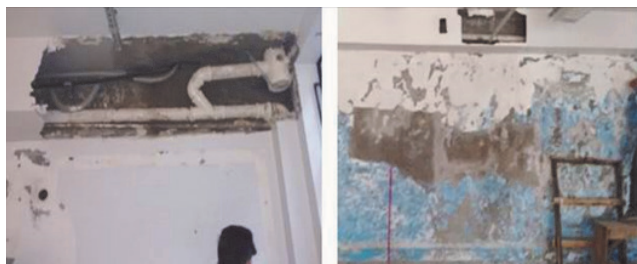
Figura 16 - Infiltrações Fonte: Os autores
