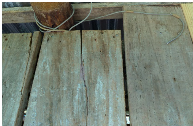
Figura 04 – Frestas nas paredes dos protótipos
