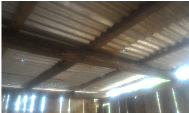
Figura 05 – Telhas e estrutura expostas internamente
