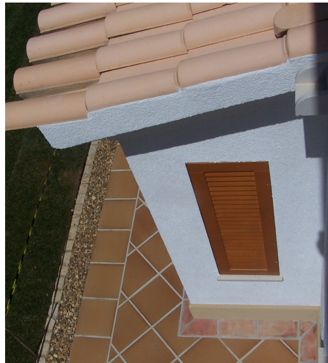
Figura 36 – Exterior – Entrada de Ar da Coolhouse Fonte: AlmaVerde.
