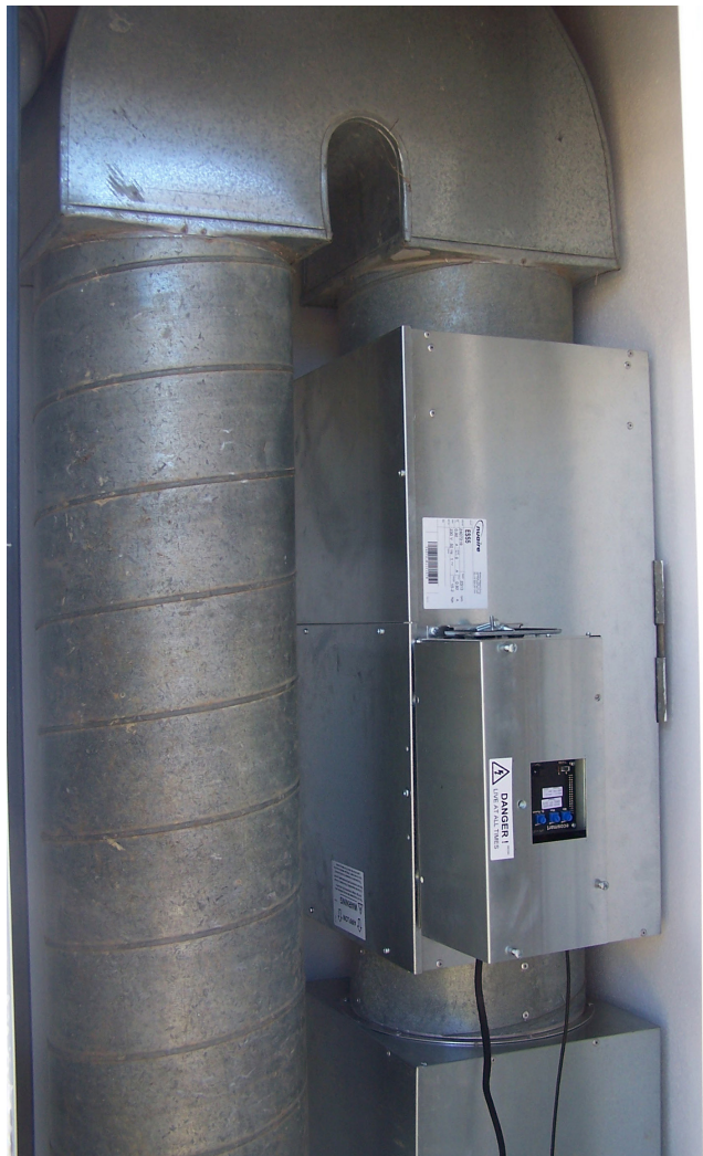
Figura 34 – Unidade de Circulação da Coolhouse Fonte: AlmaVerde.
