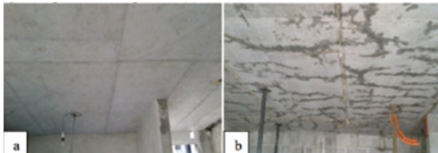
Figura 02: Acabamento da laje nos pavimentos inferiores (a) e acabamentos das lajes nos pavimentos superiores (b)
