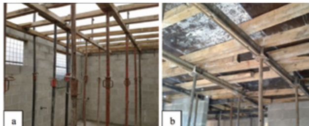
Figura 01: Escoramento da laje moldada no local (a) e formas de madeira posicionadas para concretagem (b).
