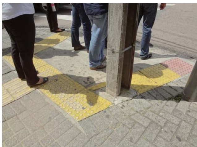
Figura 06 – Irregularidade encontrada em guia rebaixada
