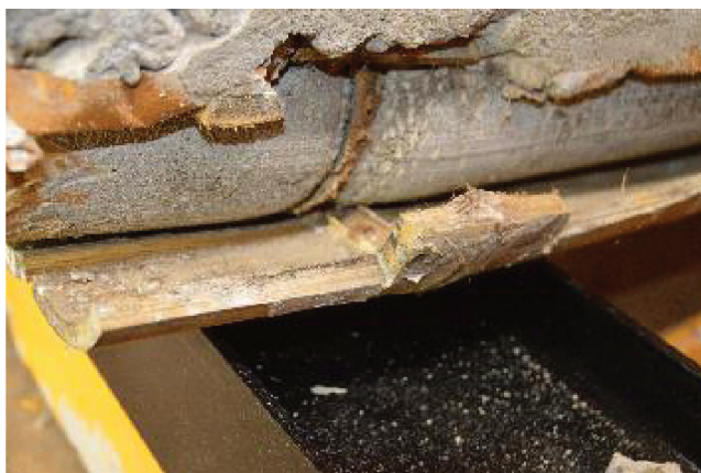
Figura 19 – Ruptura do nó de bambu.
