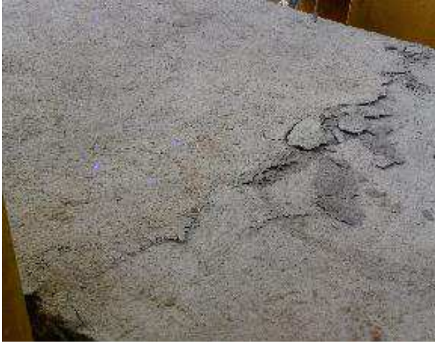
Figura 13 – Ruptura da capa de concreto.
