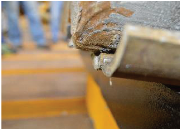
Figura 21 – Deslizamento do concreto nos apoios.
