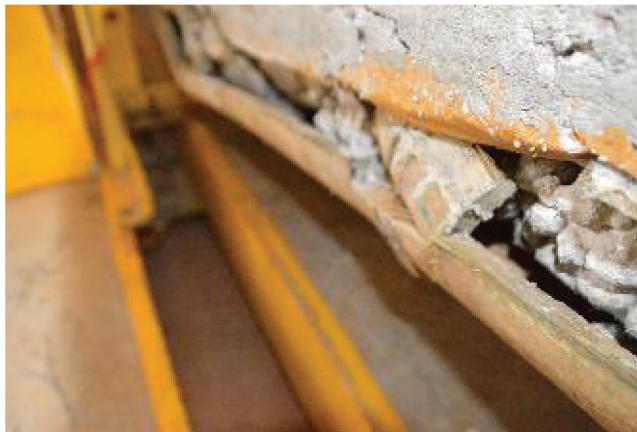
Figura 20 – Ruptura do nó de bambu.
