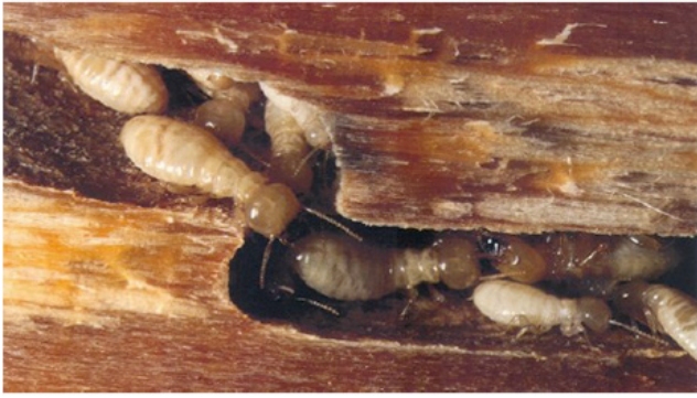
Figura 3: Galeria e sinais de ataque de cupins de madeira seca
