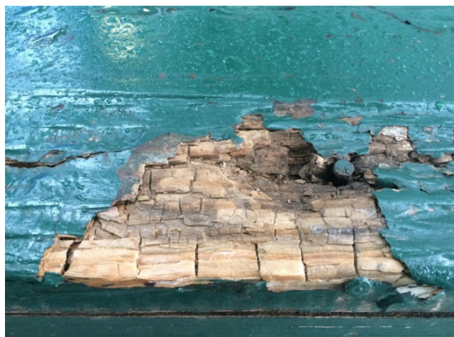
Figura 2: Madeira atacada por fungos de podridão parda
