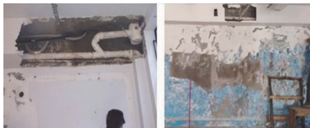
Figura 16 - Infiltrações Fonte: Os autores
