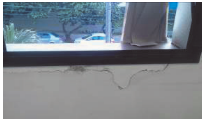
Figura 9 - Danos causados por Infiltrações diversas Fonte: Os autores
