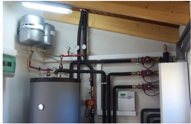
Figura 35 – Área Técnica com Caldeira a Gás, Depósito de Água Quente, Vasos de Expansão, Circuladores e Unidade de Controle. Fonte: AlmaVerde.
