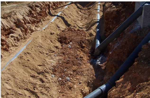
Figura 7 e 8 – Tubos da Coolhouse Fonte: AlmaVerde.
