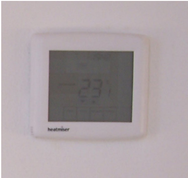
Figura 33 – Painel de Controle no Interior da Casa Fonte: AlmaVerde.
