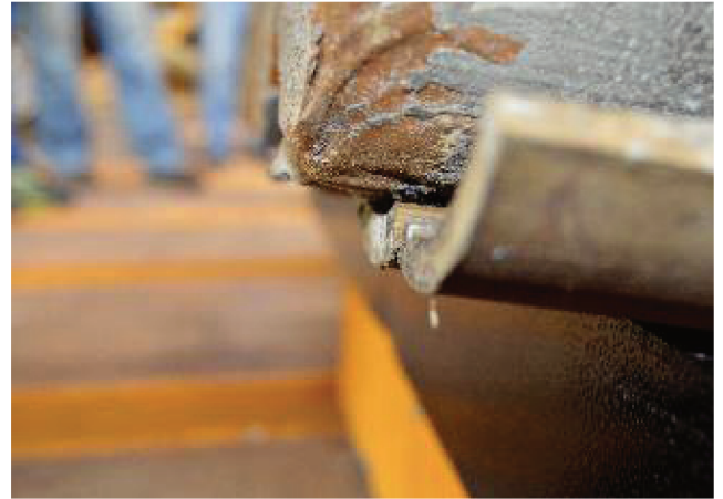
Figura 21 – Deslizamento do concreto nos apoios.
