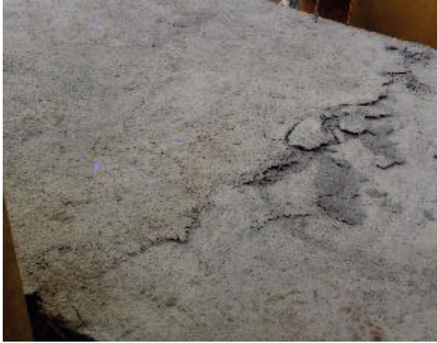
Figura 13 – Ruptura da capa de concreto.
