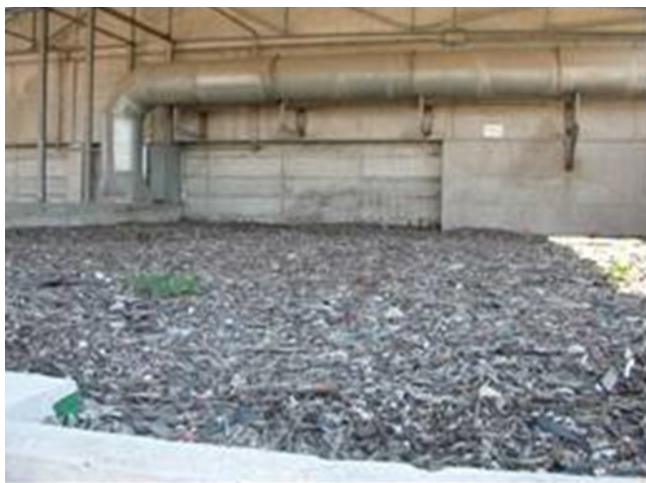
Figura 11: Biofiltro para filtragem do ar que sai de dentro da estação de tratamento.
