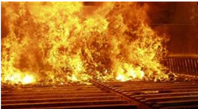
Figura 27: Queimadura dos resíduos na grelha inclinada móvel.
