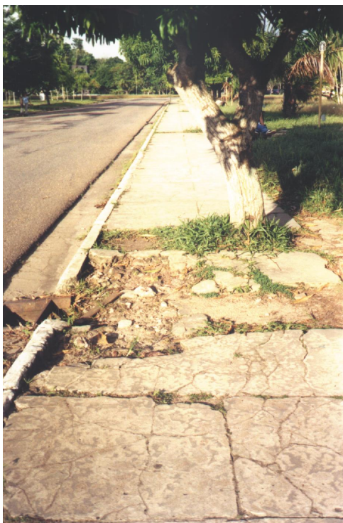
Figura 6 : Calçamento da orla mal conservada.
