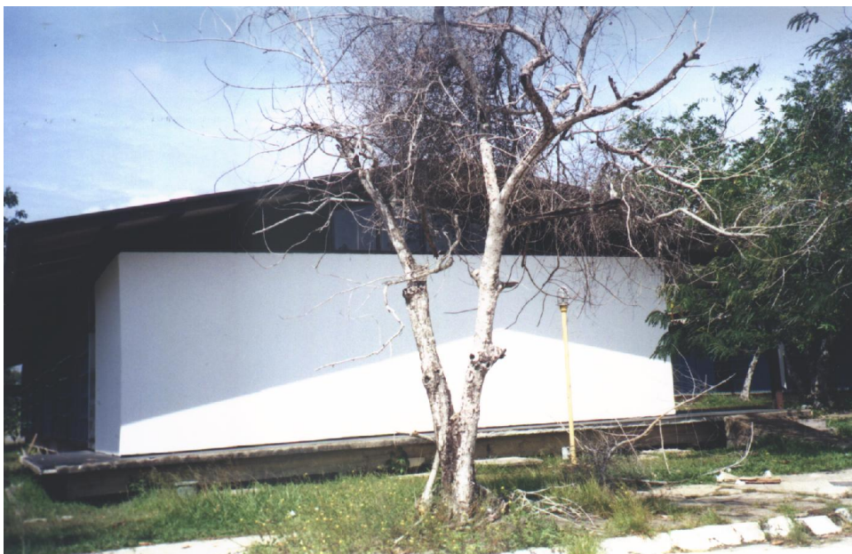
Figura 4 : Falta de manutenção do projeto paisagístico.
