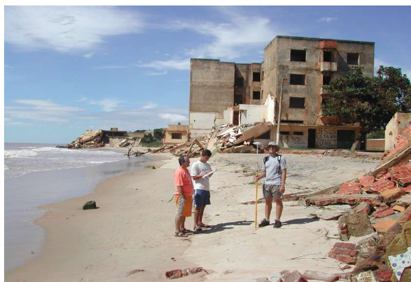
Figura 4: Fotografia indicativa de construção seriamente comprometida, condenada pela Defesa Civil: Hotel do Julinho.
