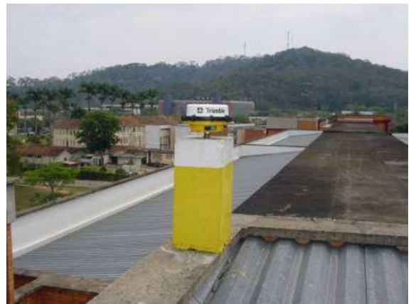
Figura 1 : Receptor GPS instalado na estação de observação com pino de centragem forçada
