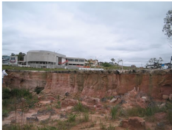
Figura 03: Solo cedeu, arrastando a galeria de águas pluviais
