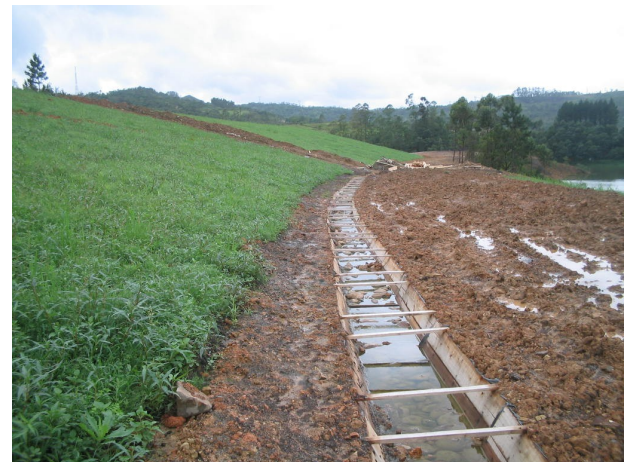
Figura 9: Canal com revestimento lateral de madeira serrada e fundo em seixo rolado.
