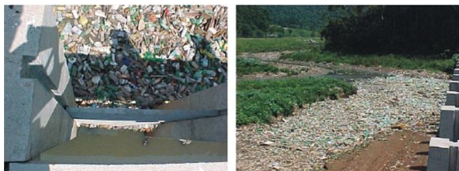
Figura 5 : Embalagens plásticas que obstruem o escoamento nos canais de drenagem (Tucci, 2002)
