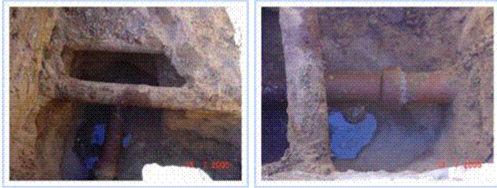
Figura 2 : Rede rompida e Vazamento.
