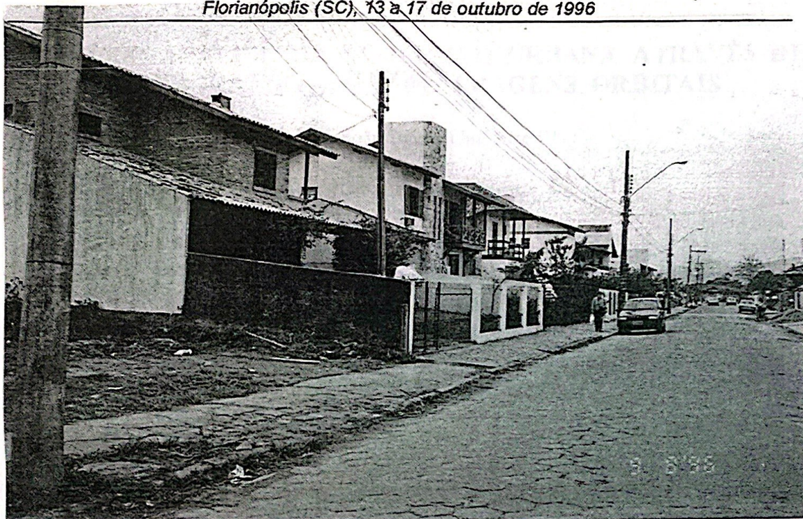
Fotografia nº 3 - Bairro Santa Mônica, antiga área de mangue, edificação executada no início da ocupação da área, hoje se encontra abaixo do nível da rua, devido ao constante assoreamento das baixadas. Rua Madre Benvenuta.
