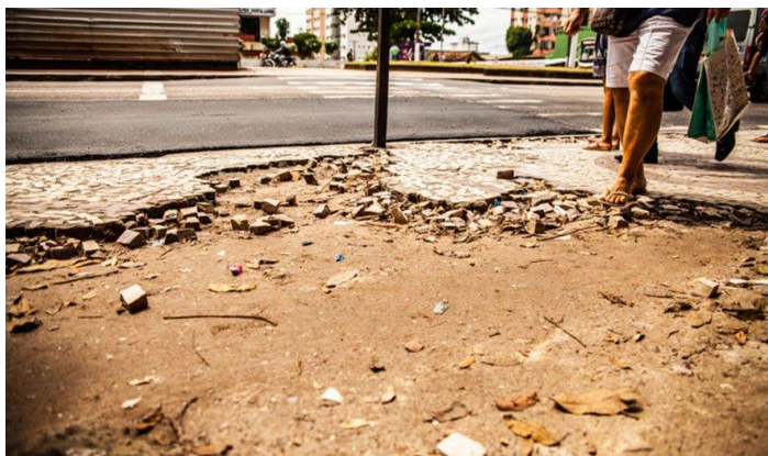
Figura 1 - Calçada do Bosque Rodrigues Alves totalmente danificada em Belém do Pará Fonte: http://www.diarioonline.com.br/noticias/para/noticia-399466-descaso-com-calcadas-do-bosque-oferece-riscos.html
