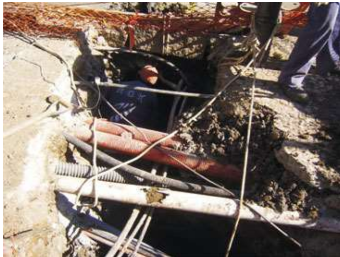
Foto 1 - Subsolo congestionado apresentando interferência entre redes.
