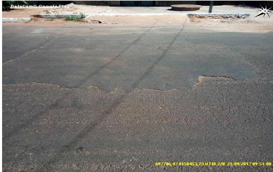
Figura 7: Remendo Superficial Fonte: Google Maps (Setembro/2017).
