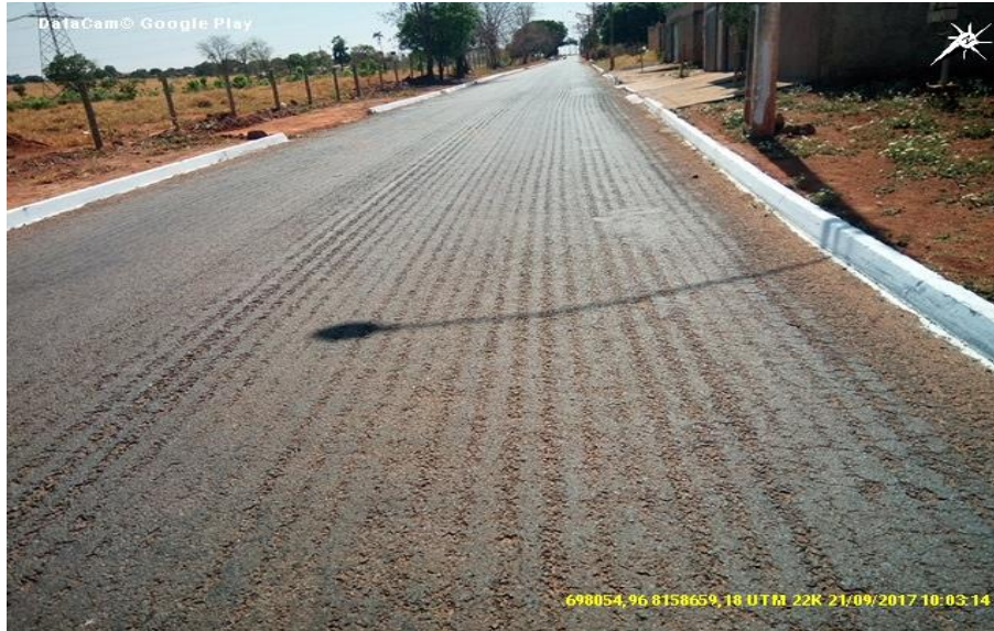
Figura 5: Falha de Bico espargidor Fonte: Google Maps (Setembro/2017).
