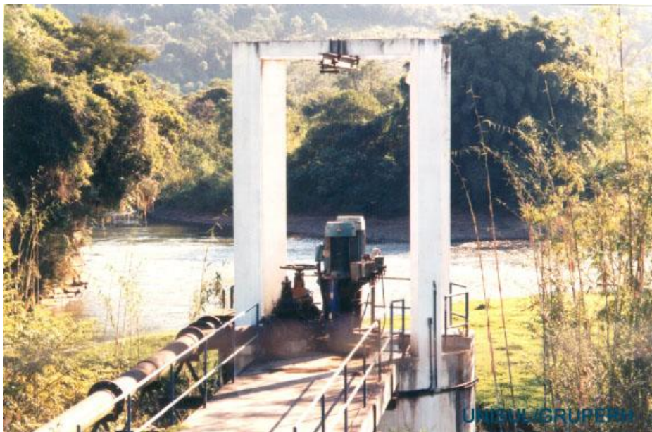
Figura 4 :Valores tangíveis - Captação de água para abastecimento público Fonte: UNISUL/GRUPERH
