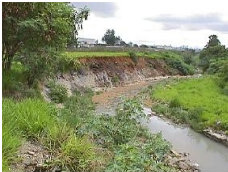
Figura 14 : Erosão no talude
