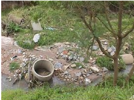
Figura 18 : Tubo carregado pelas águas
