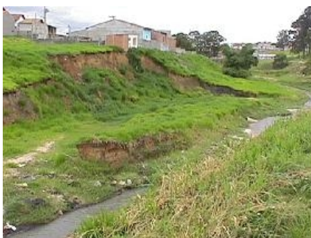
Figura 16 : Escorregamento do talude
