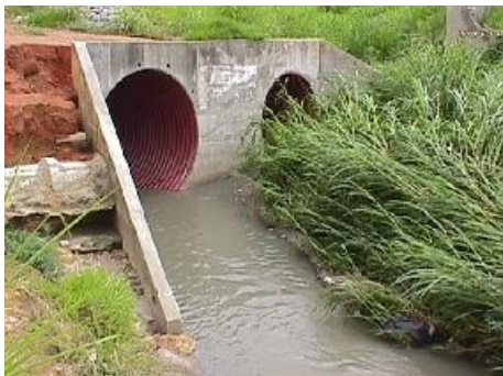
Figura 15 : Erosão na ala da galeria
