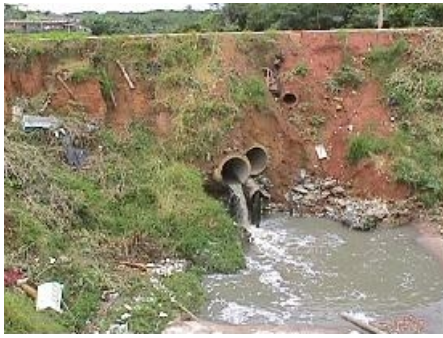
Figura 17 : Rompimento da linha de tubos
